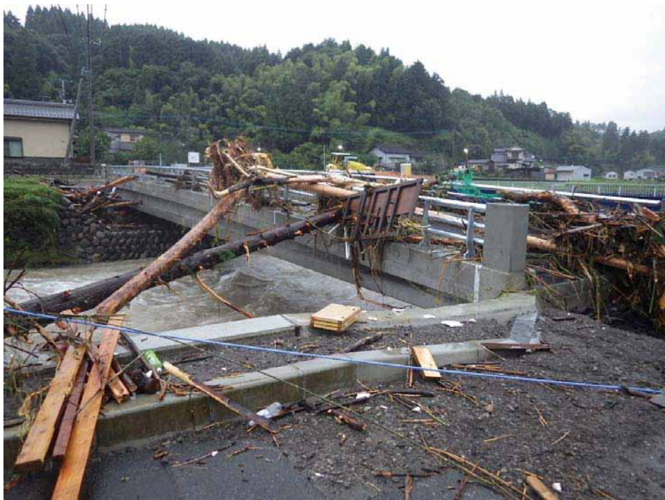
有田川被災状況（日田市大字東有田）【九州北部豪雨】
