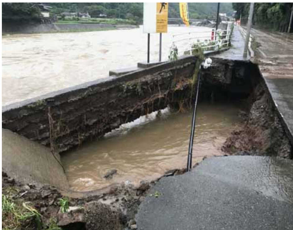
国道212号被災状況（中津市耶馬溪町大字柿坂）【九州北部豪雨】
