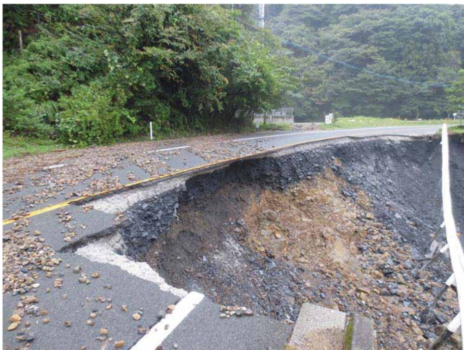
(主)佐伯津久見線被災状況（津久見市大字津久見）【台風第18号】
