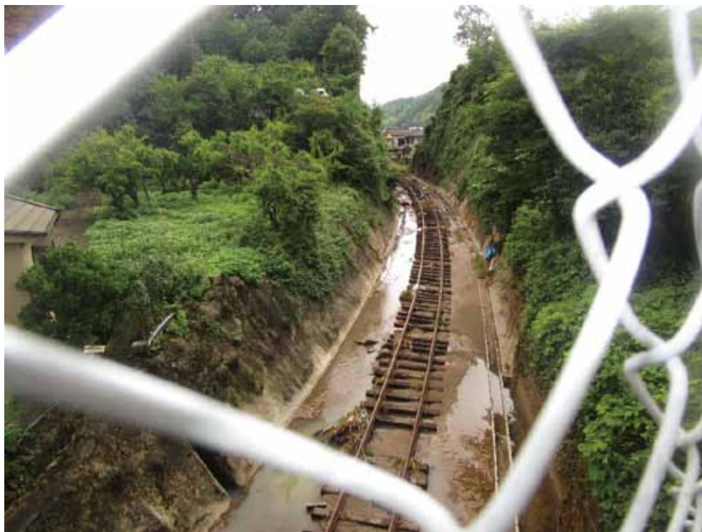
大肥川被災状況（日田市大字大肥） J R 日田彦山線 【九州北部豪雨】
