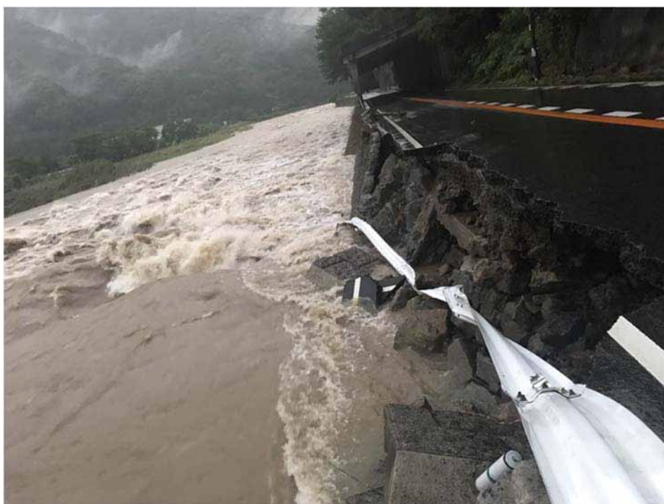
国道212号被災状況（中津市本耶馬溪町多志田）【九州北部豪雨】
