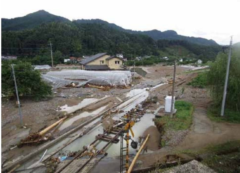
大肥川被災状況（日田市大字大肥）【九州北部豪雨】
