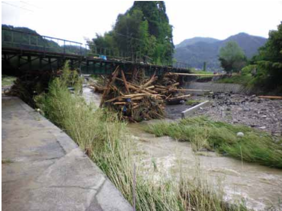
大肥川被災状況（日田市大字大肥）【九州北部豪雨】
