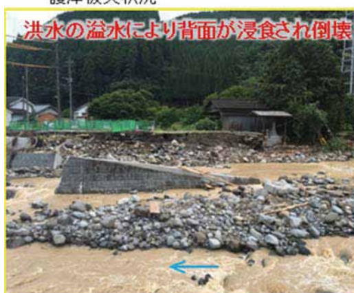
護岸被災状況
