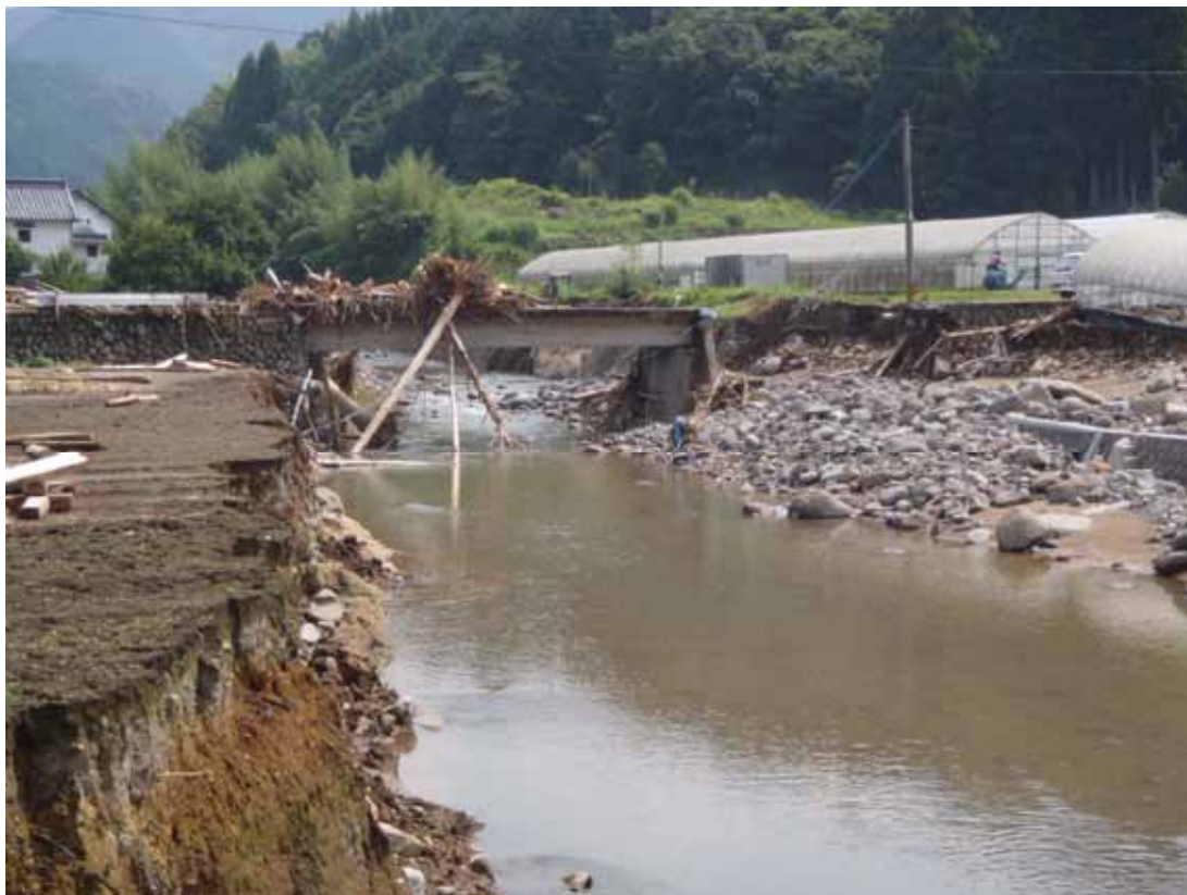
鶴河内川被災状況（日田市大字鶴河内）【九州北部豪雨】
