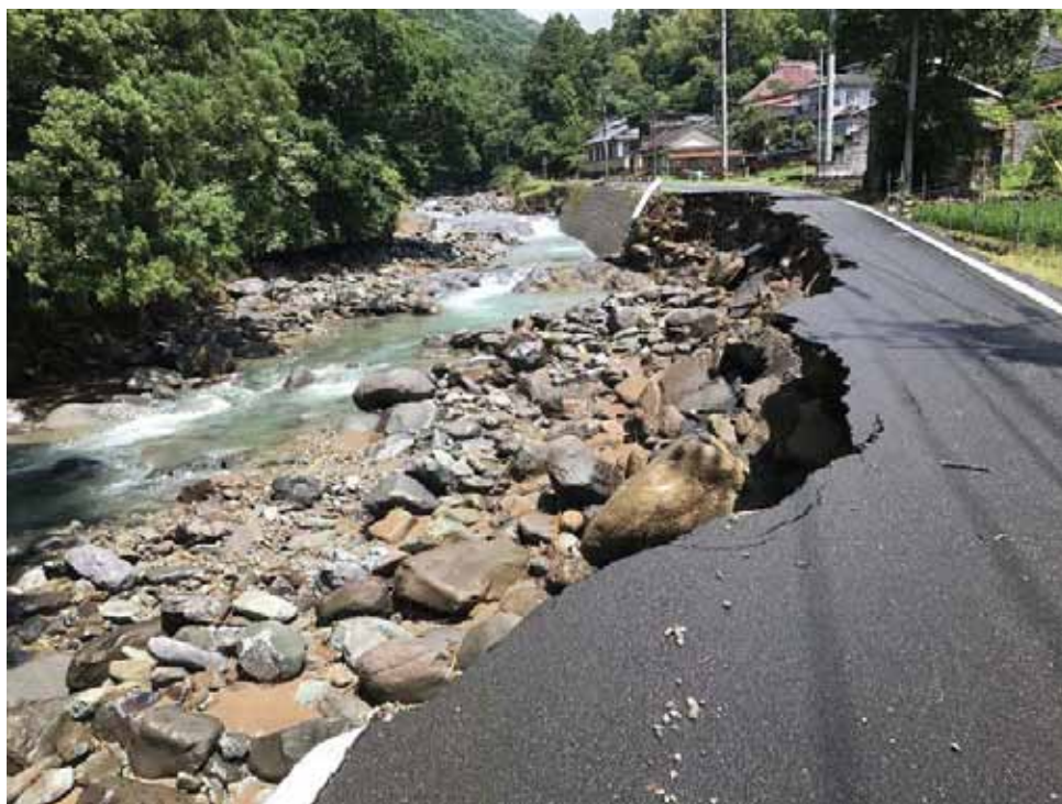
小野川被災状況（日田市大字小野）【九州北部豪雨】
