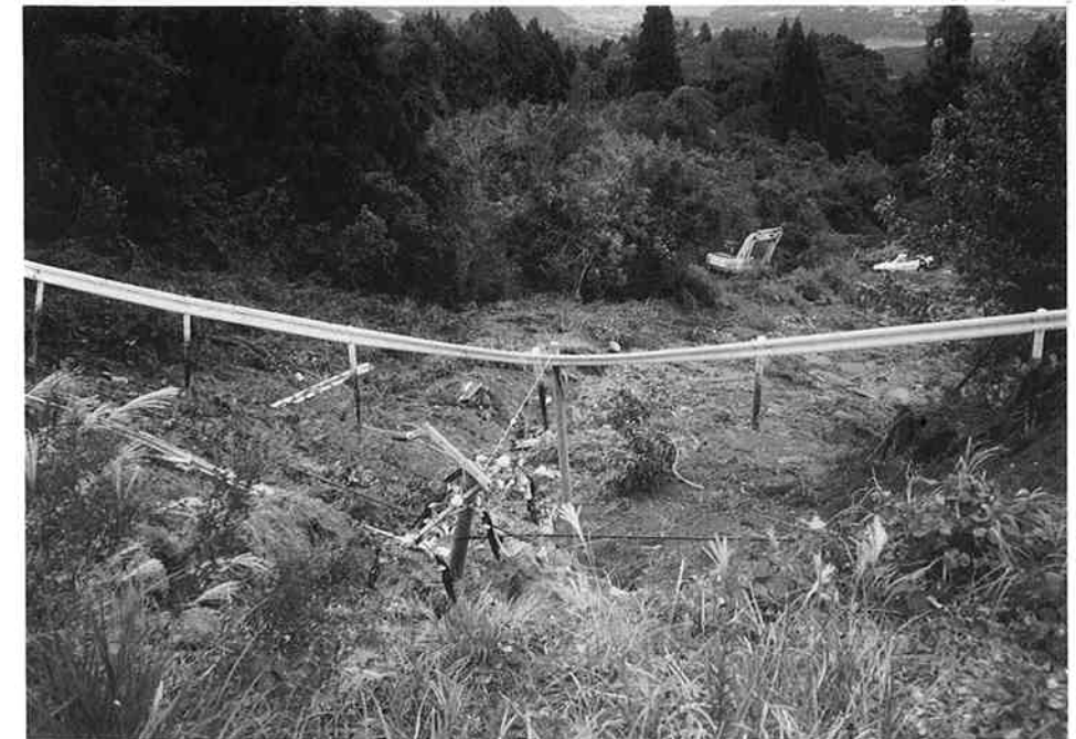
法面崩壊による市道の崩落
