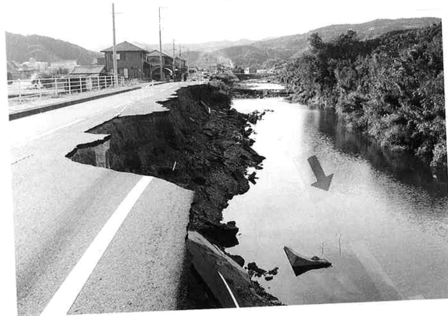
末広川護岸決壊による県道大分臼杵線の崩壊
