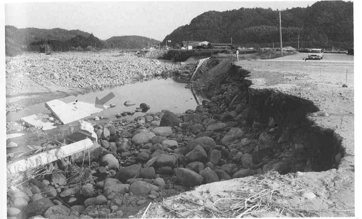
津房川 安心院町大字荘 津房川護岸決壊による被害状況
