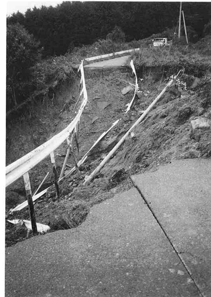
法面崩壊による市道の崩落
