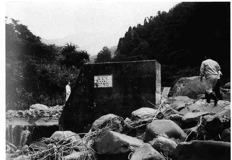
土石流及び河床洗掘による床固工の被害状況
