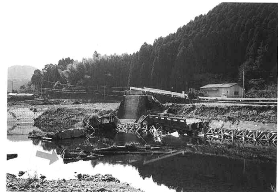
久留須川洪水により橋脚が流出し、落橋倒壊
