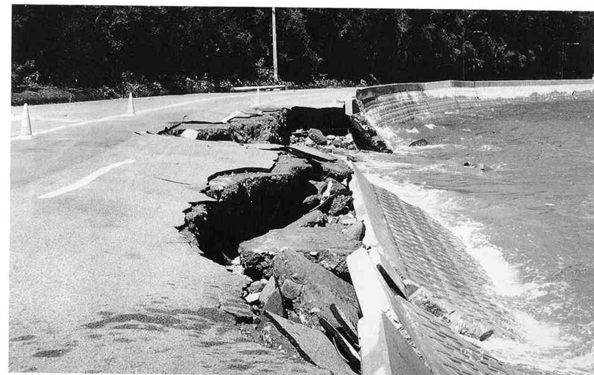
町道 長瀬川高島線の決壊（国見町）
