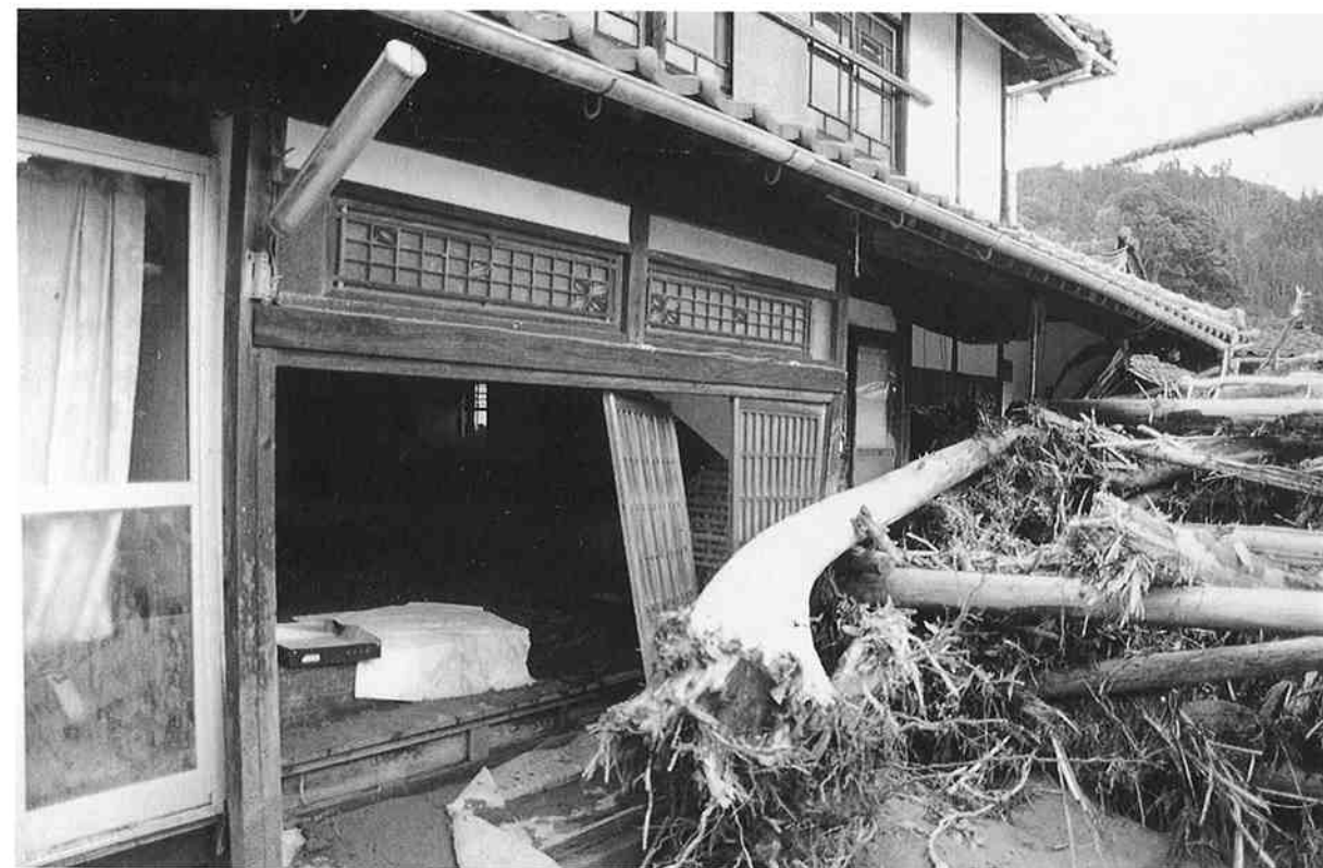
流木が人家を壊した状況 (本耶馬溪町)
