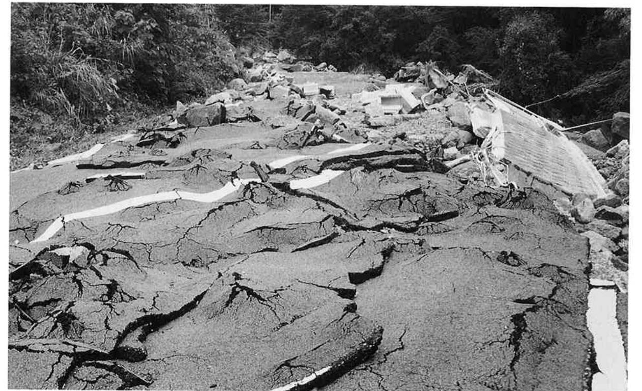
県道 深耶馬院内線の決壊（耶馬溪町）
