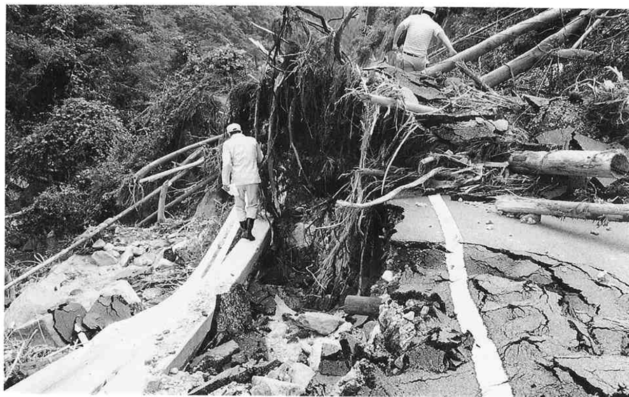
県道 深耶馬院内線の流木埋没 (耶馬溪町)
