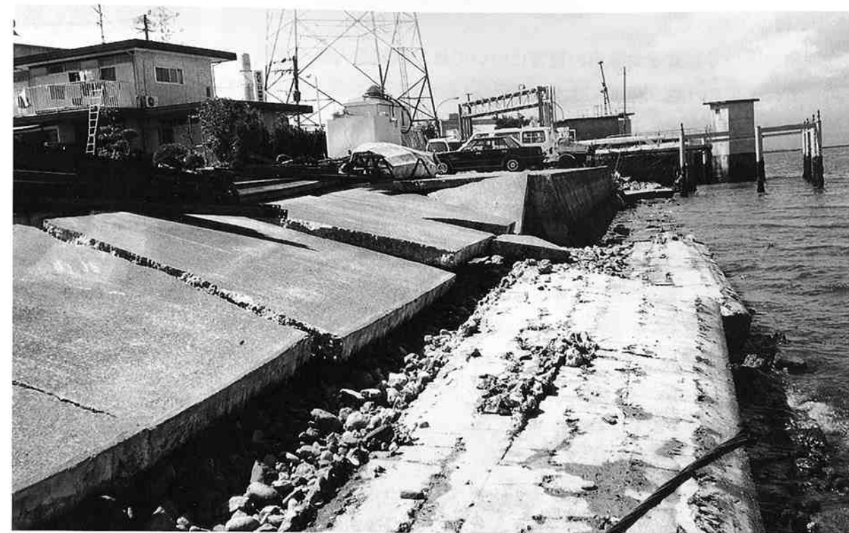
大分港 護岸の決壊 [大分市]
