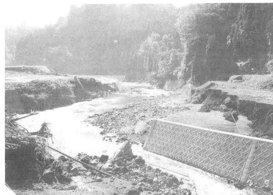
滝水川右支川の護岸災害（竹田市）
