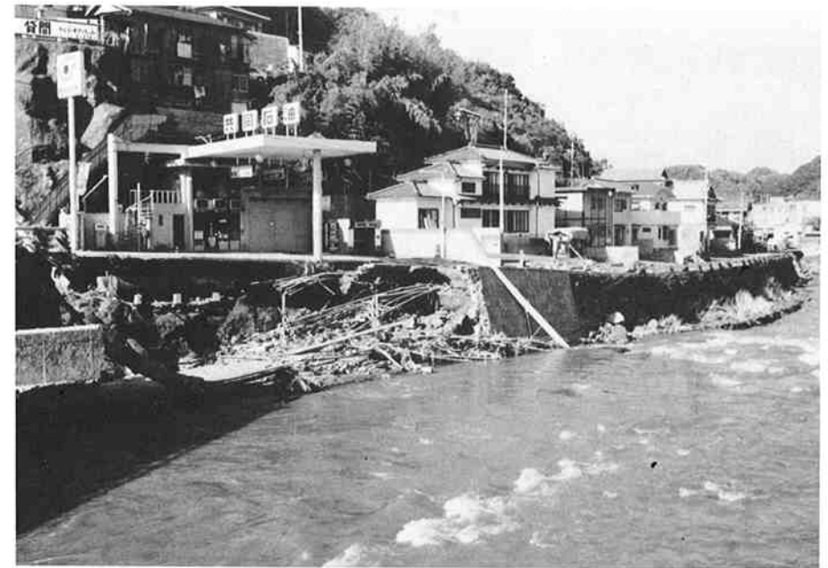
豊岡橋下流の護岸決壊（竹田市）
