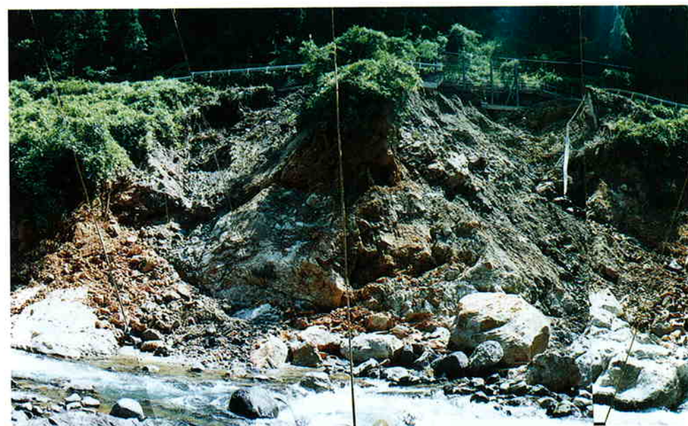
県道天ヶ瀬阿蘇線の路肩崩壊（上津江村）
