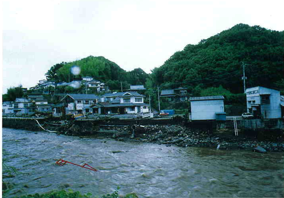
稲葉川豊岡橋下流の護岸崩壊（竹田市）
