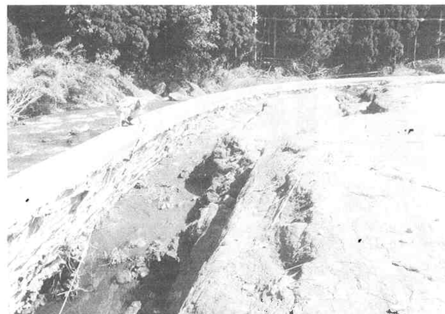
滝水川の護岸災害（竹田市）
