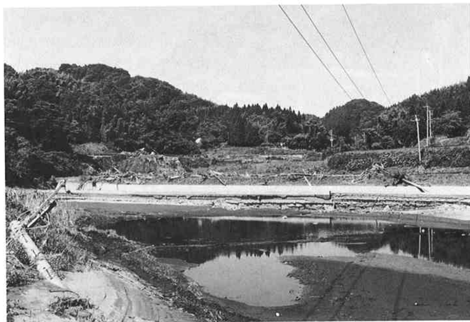
稲葉川の護岸決壊（久住町添ヶ津留）
