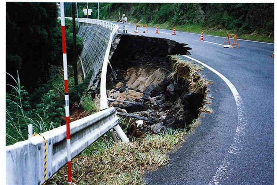
県道朝地直入線の決壊（竹田市）
