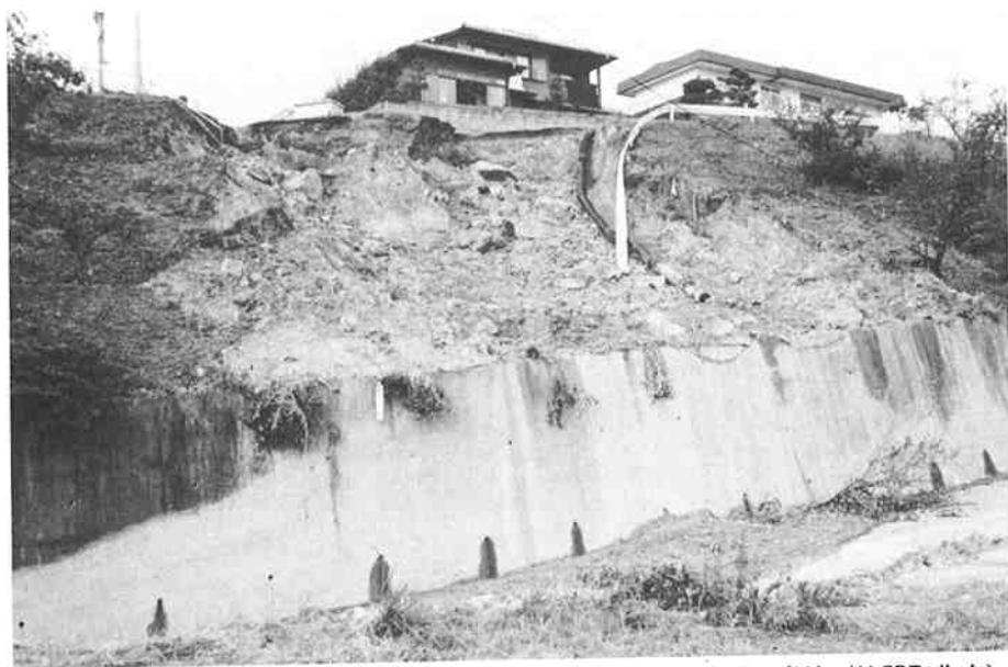
台風21号による町道喜多里線法面の崩壊（狹間町北方）
