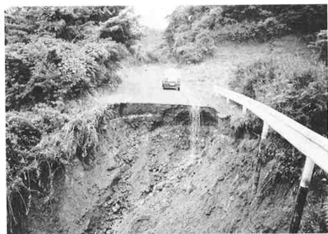
県道竹田直入線の路面崩壊（竹田市）
