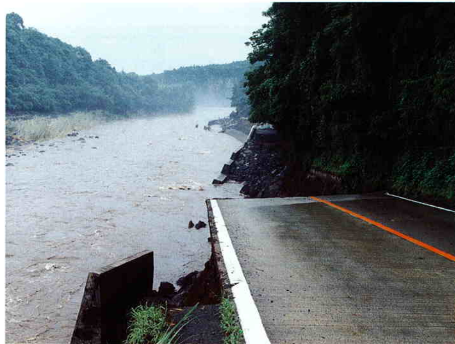
県道竹田野津線の決壊（清川村岩戸付近）
