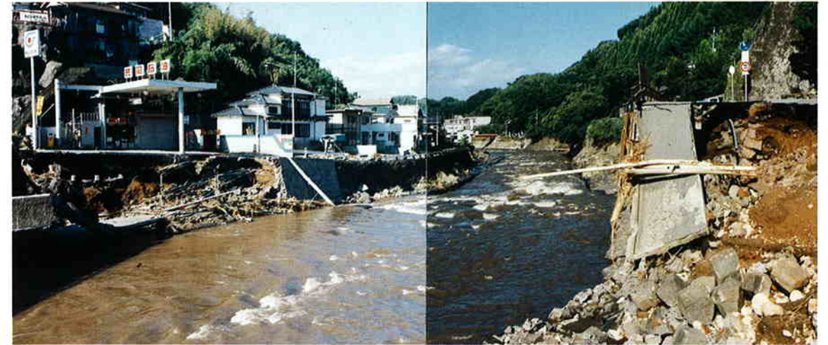
稲葉川豊岡橋上流の護岸崩壊（竹田市）
