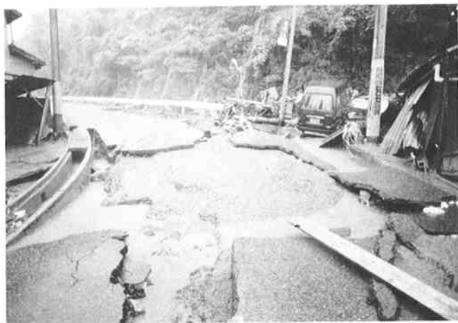
県道高森竹田線の路面の剥離（竹田市）
