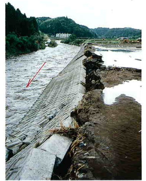
大野川の護岸崩壊（緒方町）
