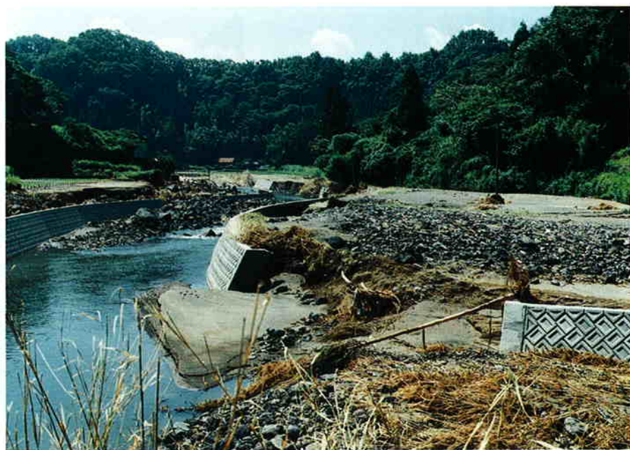
滝水川南河内付近の護岸崩壊（荻町）
