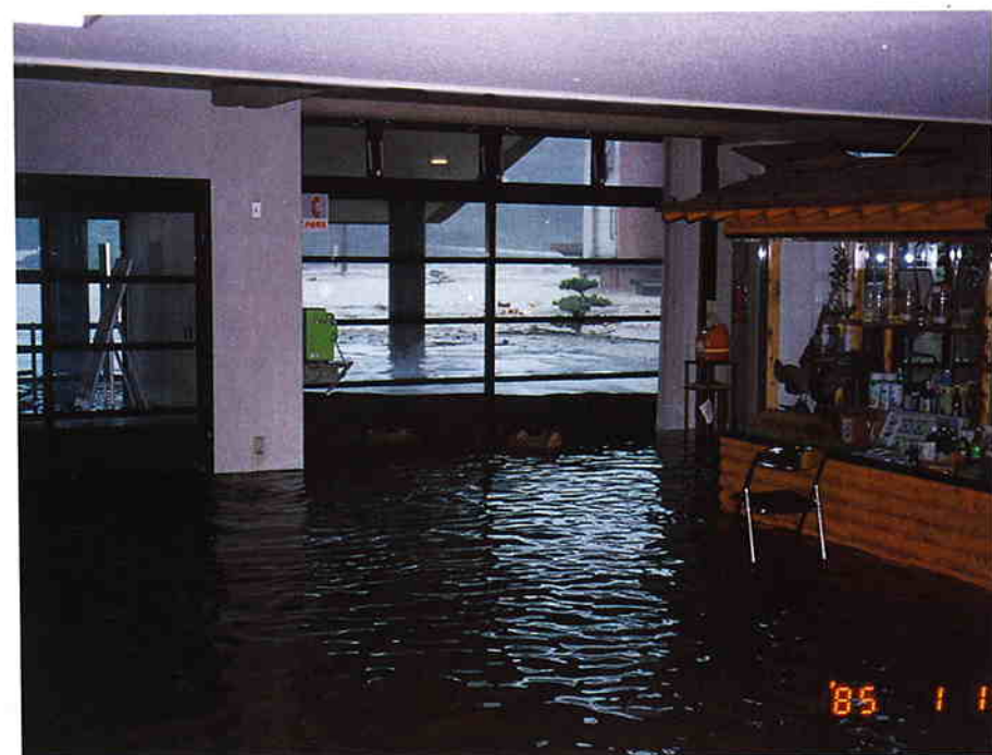
県竹田総合庁舎の浸水
