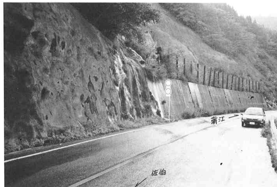
台風21号による国道388号の法面の崩壊（佐伯市木立）被災前
