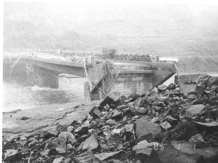
県道緒方朝地線猿飛橋の流失（緒方町）
