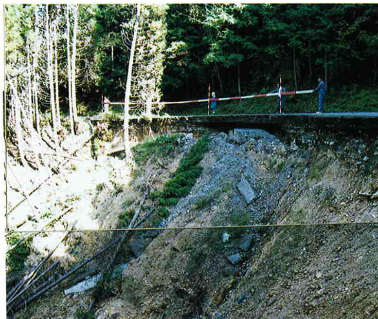
村道石場線の路肩崩壊（中津江村）
