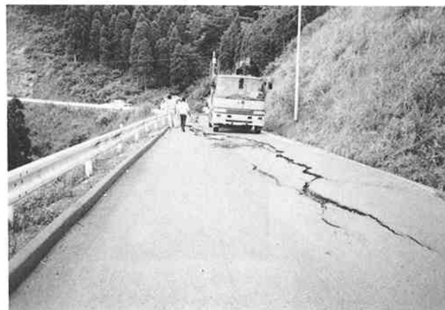
県道鯛生釈迦岳線の路面の亀裂（中津江村） 村
